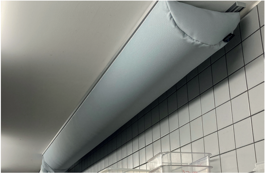
Abb. 21: Textiler Zuluftdurchlass an der Decke
