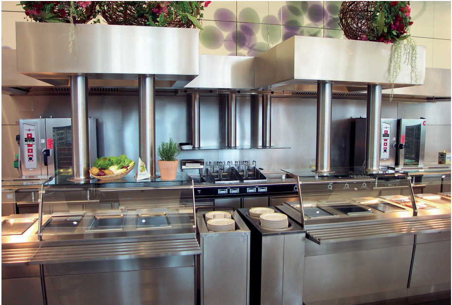
Abb. 6: Düsenplatten im Frontcooking-Bereich
